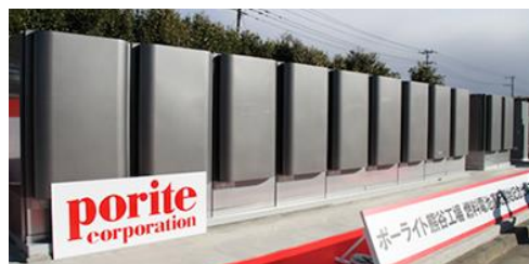
左：セパレータ 右：当社熊谷第二工場に設置されている燃料電池
